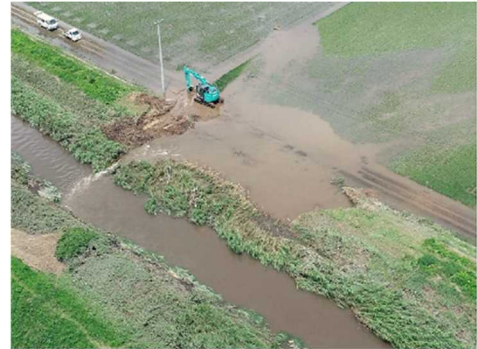
写真 1-1-1 災害の記録写真（名蓋川堤防決壊状況（鳴瀬川水系）） （出典）宮城県公式サイト みやぎ水害記録集（令和4年7月洪水）
