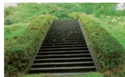
転落防止対策が望まれる階段
