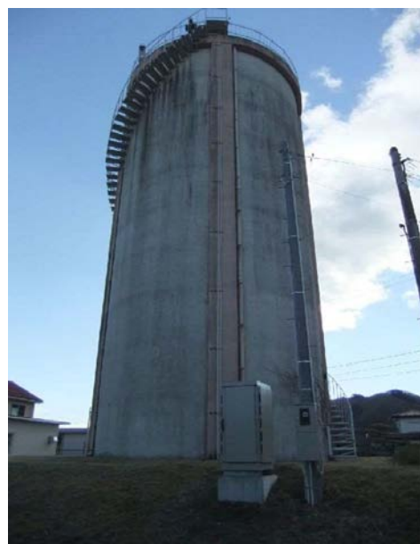
[サニータウン配水池]
