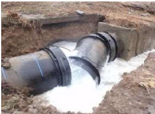
[写真：2011 年東北地方太平洋沖地震による水道施設の被害写真集より引用]
