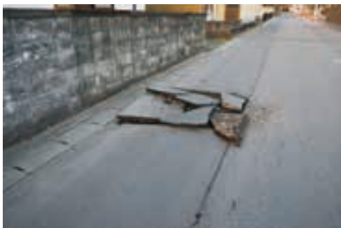
地震の影響により破損した道路（祝田付近）
