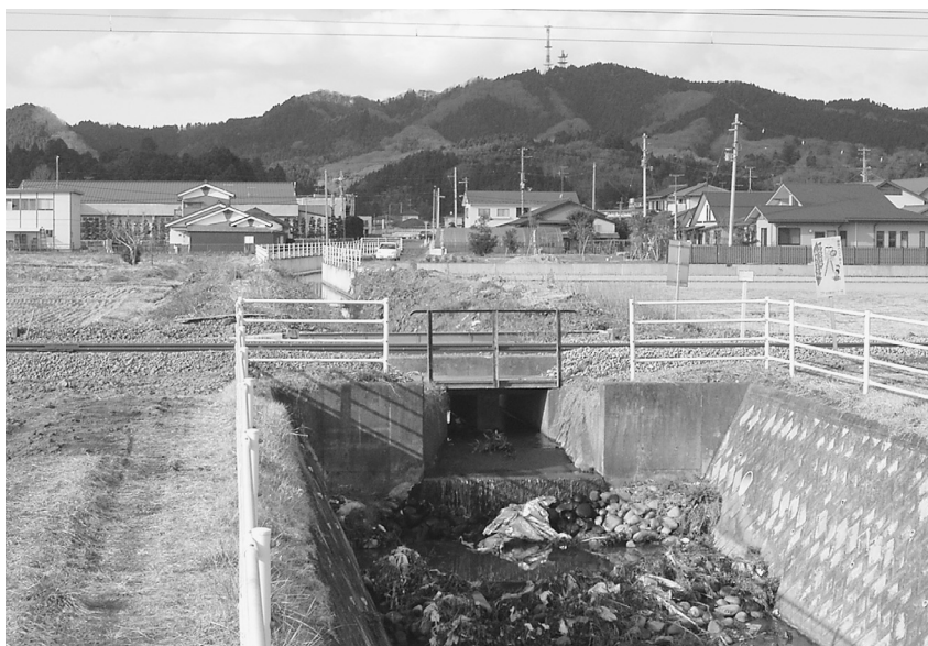
川があふれる原因となる線路下を通る狭い水路
