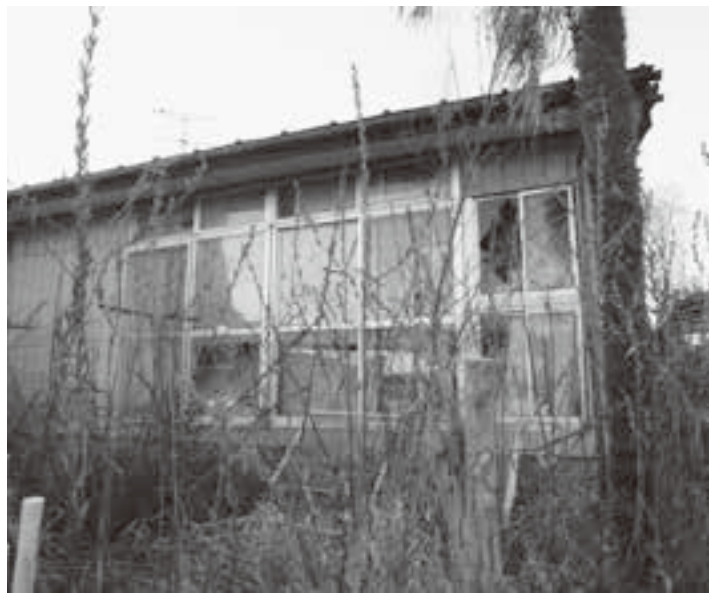
危険な空き家
